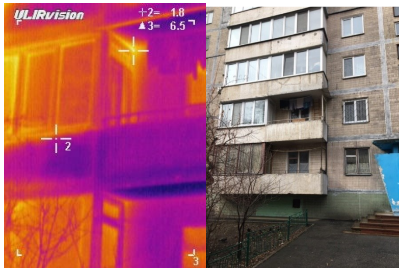
Рисунок 3 – Тепловізійна зйомка фасаду будинку
