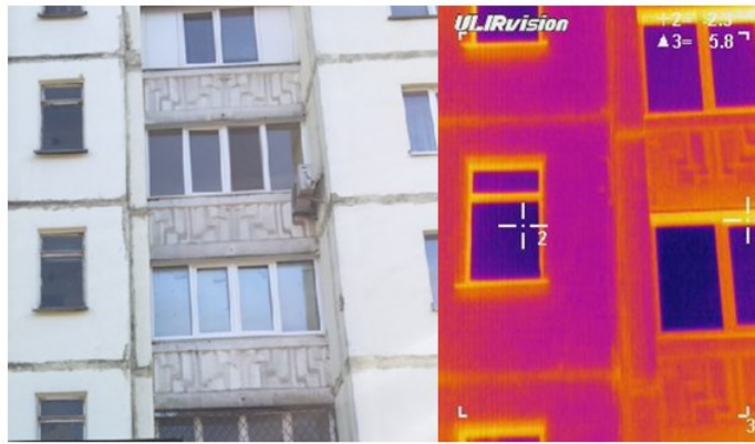
Рисунок 3 – Тепловізійна зйомка фасаду будинку
